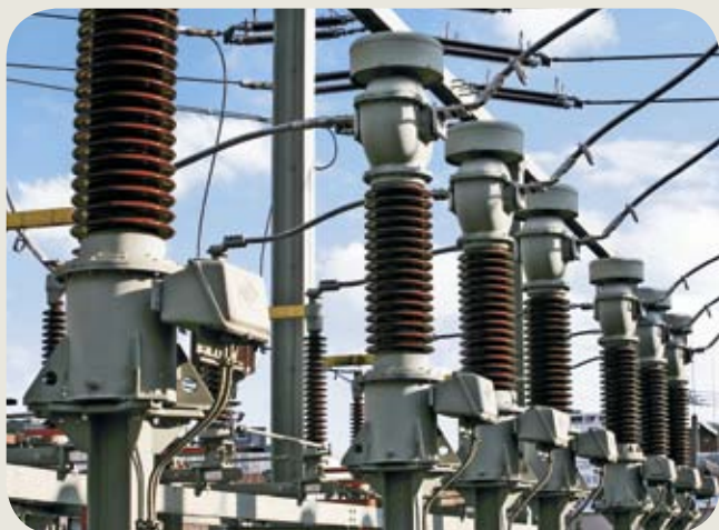
In den 28 Umspannanlagen der HSE wird der Strom von Hochspannung auf Mittelspannung transformiert.
