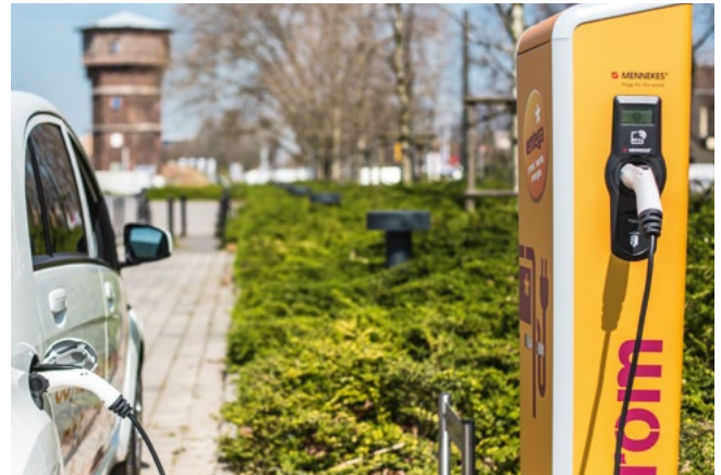
Neue Ladesäulen für die Region.
