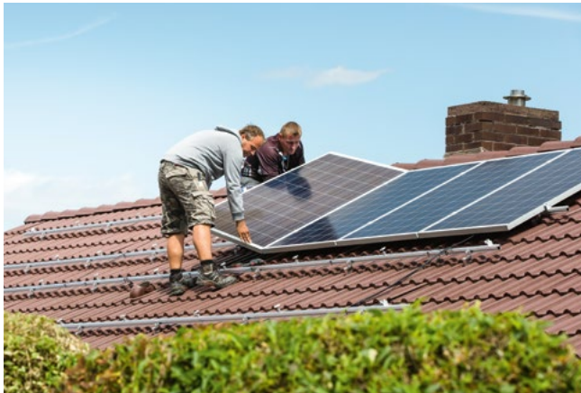
Solaranlage pachten statt kaufen.
